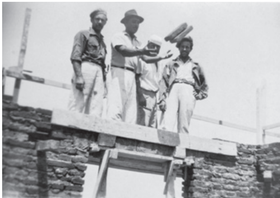
Obreros en la construcción de los hoteles de la Unidad Turística Chapadmalal. (c. 1947). MUSEO EVA PERÓN, CHAPADMALAL.
