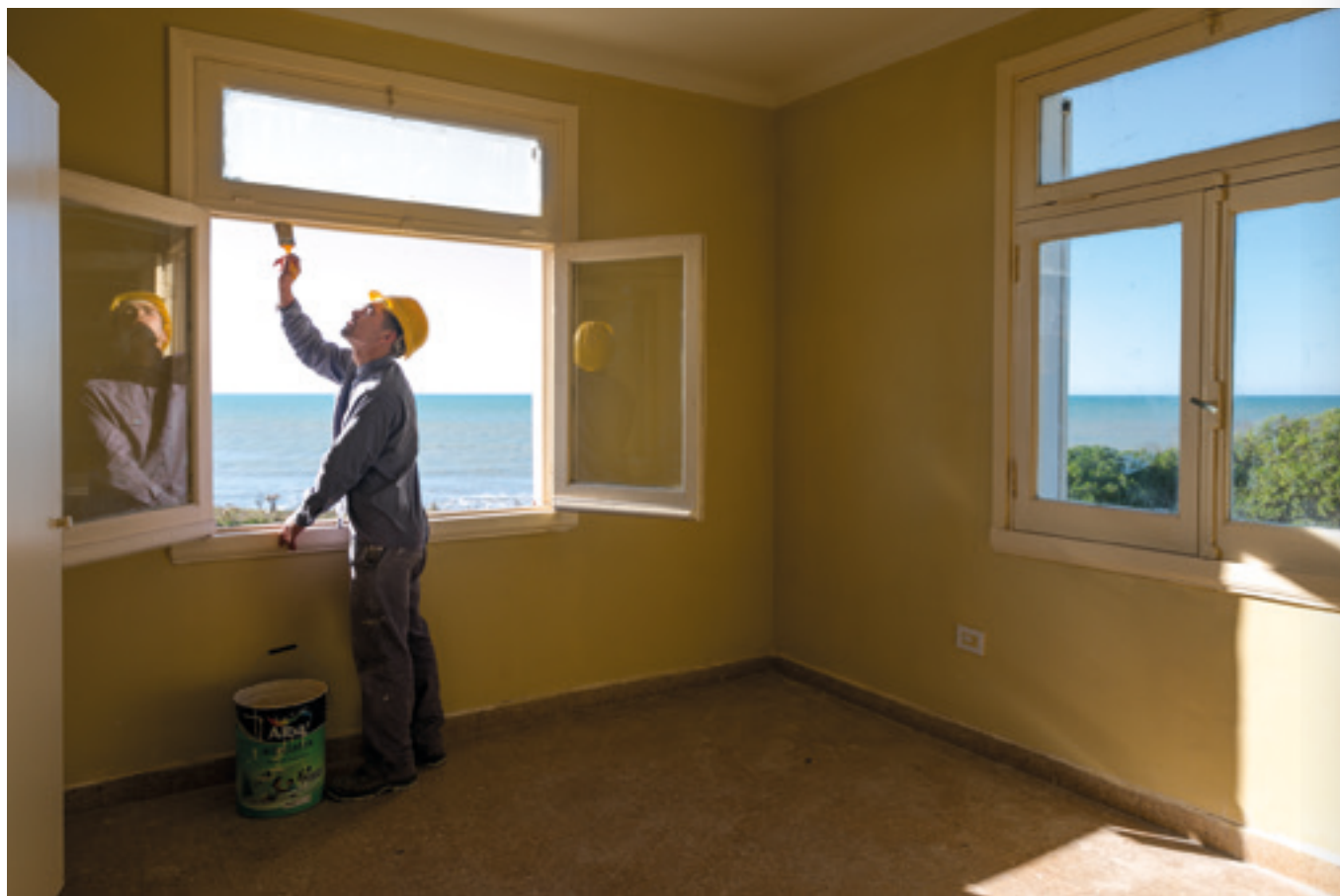
Interior de una de las habitaciones en el Hotel 6 de la Unidad Turística de Chapadmalal durante las obras de refacción y puesta en valor. (2022). ESTRELLA HERRERA. MINISTERIO DE TURISMO Y DEPORTES DE LA NACIÓN.
