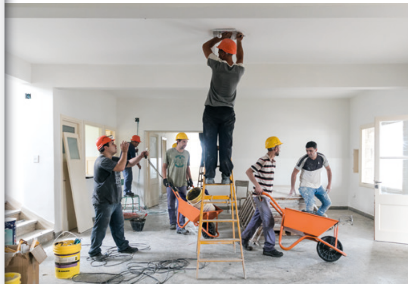
Recepción del Hotel 6 de la Unidad Turística de Chapadmalal durante las obras de refacción y puesta en valor. (2022). ESTRELLA HERRERA. MINISTERIO DE TURISMO Y DEPORTES DE LA NACIÓN.
