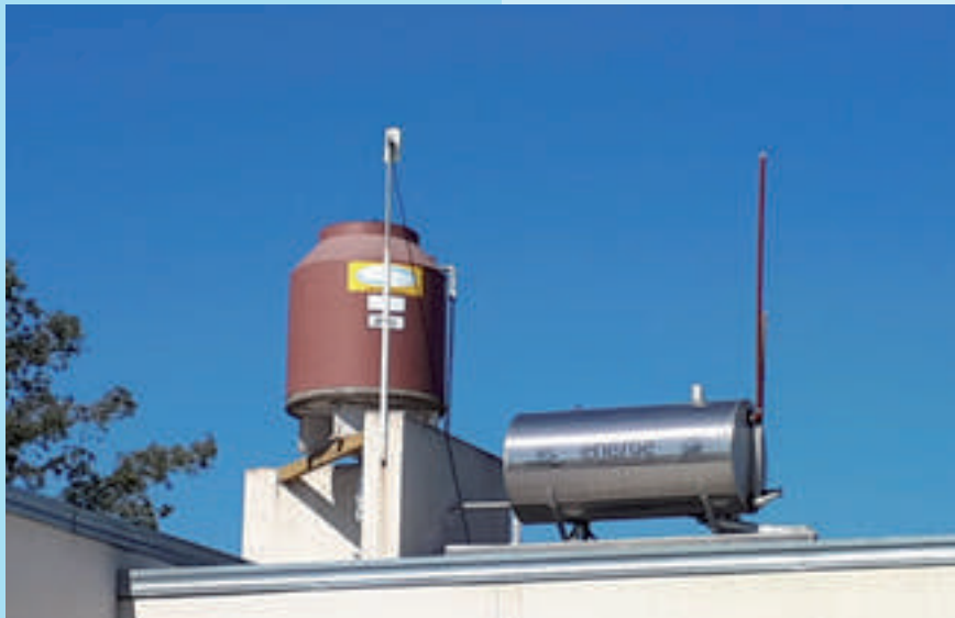
Figura 64: Instalaciones solares térmicas en viviendas sociales de San Carlos Sud. Fuente: Carrizo, 2018
