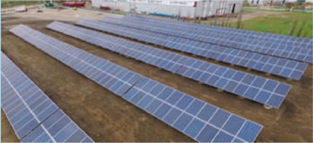
Figura 63: Instalaciones fotovoltaicas en la localidad de Armstrong.
