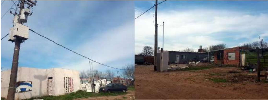
Figura 68: Instalaciones eléctricas en Junín para reducir conexiones clandestinas y mejorar servicios. Fuente: Carrizo, 2018
