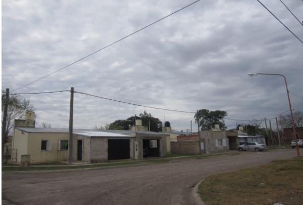
Viviendas con problemas de mantenimiento FUENTE: Elaboración Propia
