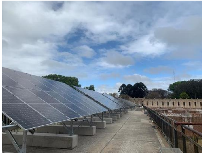
Imagen 6: Paneles solares ubicados en PSM
