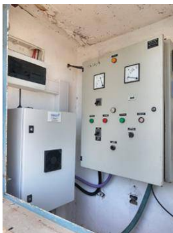
Imagen 3: Tablero de medición instalado
