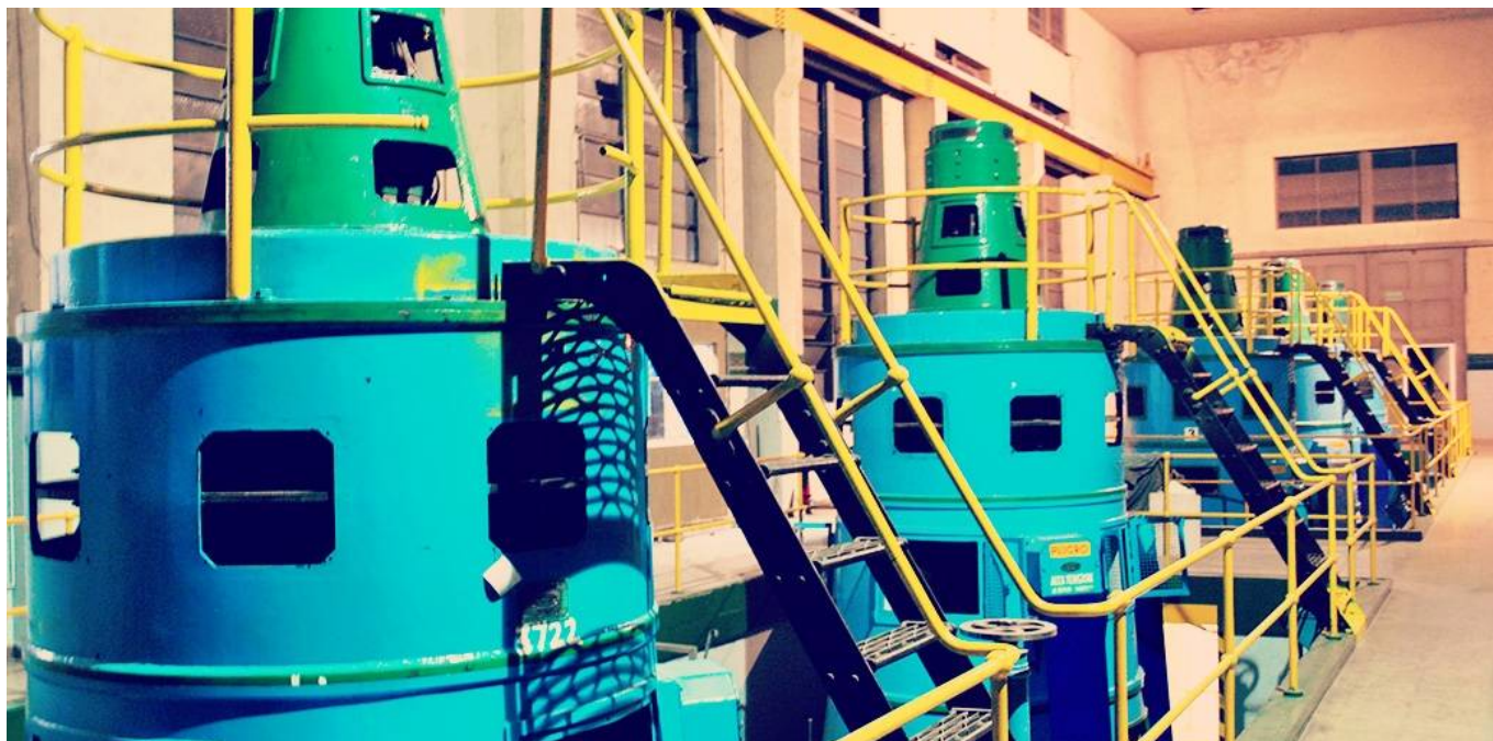
Imagen 9: Foto sala de Bombas Estación Elevadoras
