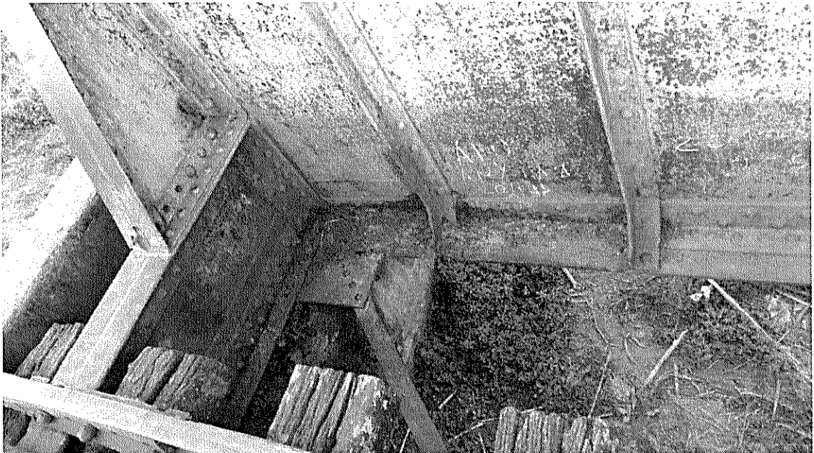
Detalle de corrosión de platabandas inferiores en zona de apoyo
