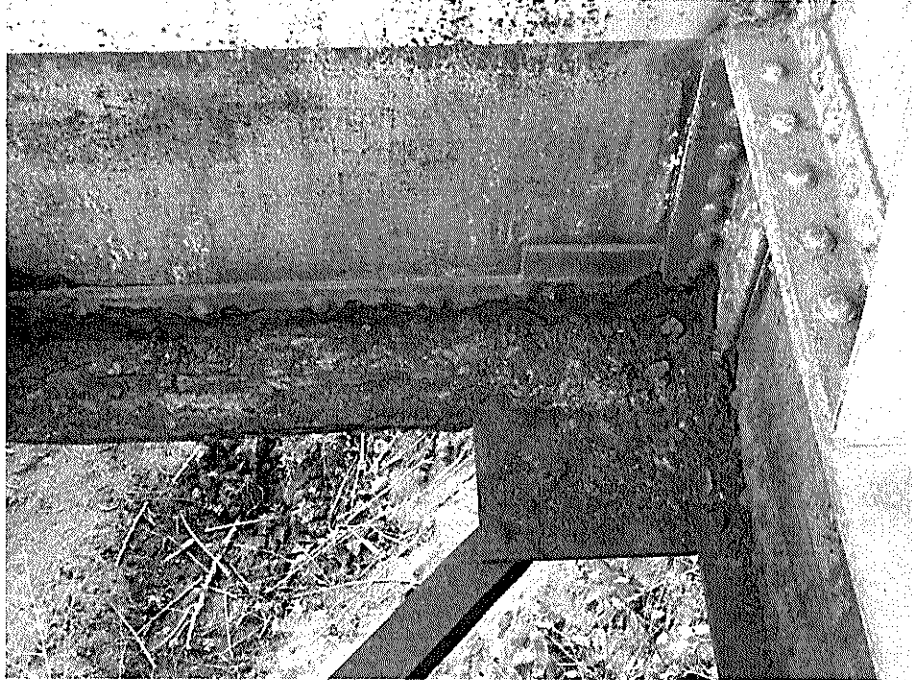
Detalles de la corrosión en los elementos de unión en tramo N°1 a reemplazar
