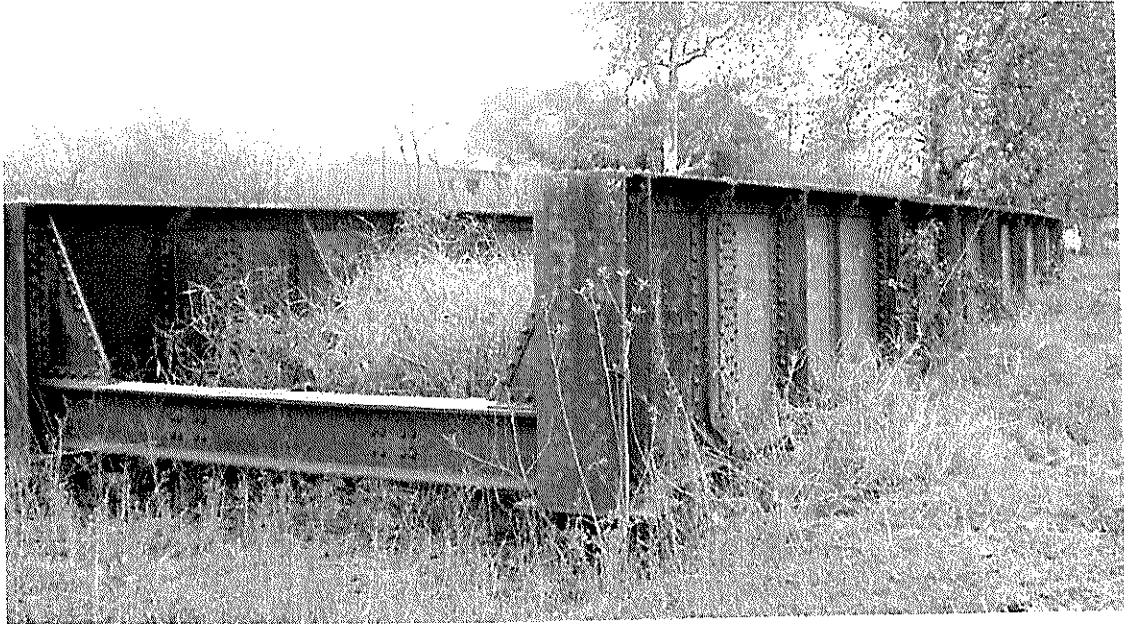
Tramo metálico de iguales características ubicado en la estación G. Fernandez
