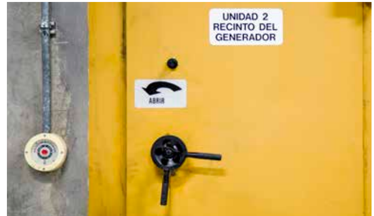
Unidades de generación. Acceso al generador N°2, Piedra del Águila.
