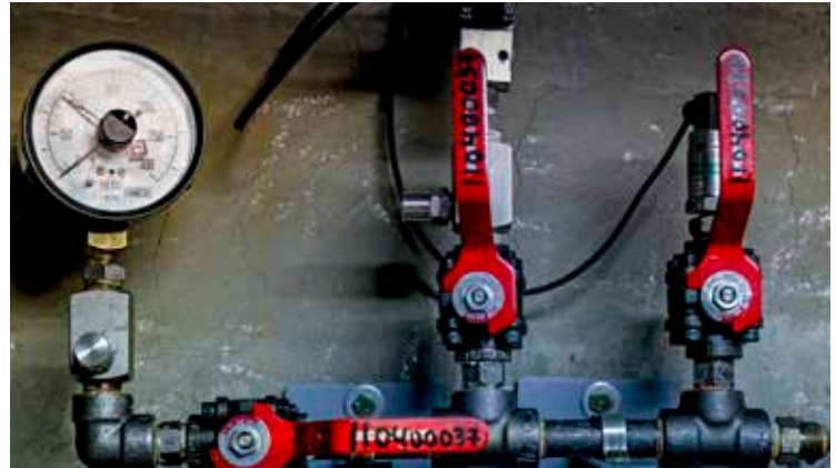
Manómetro y tuberías de inyección, Piedra del Águila.
