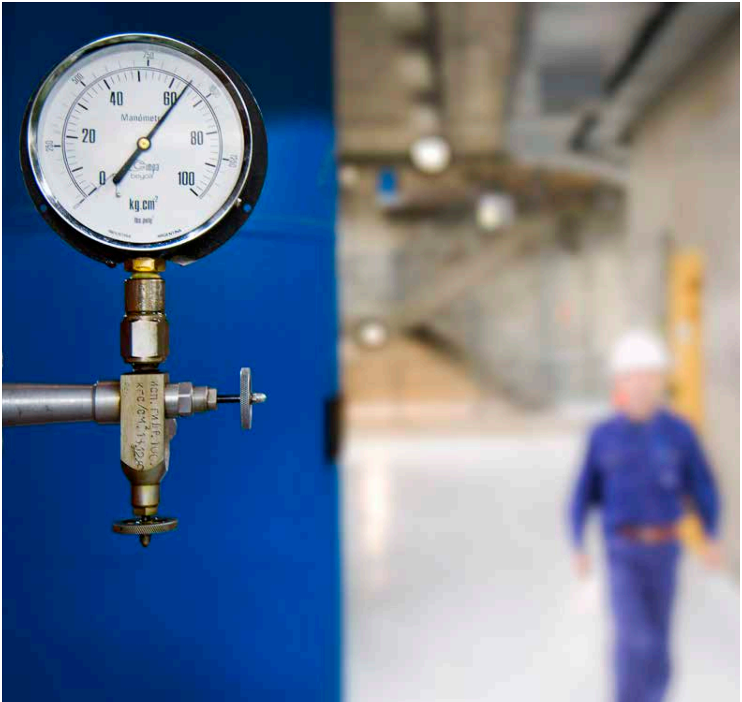
Manómetro, central hidroeléctrica Piedra del Águila, Neuquén y Río Negro.
