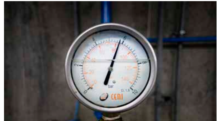
Servicios auxiliares. Manómetro del sistema de lubricación, Piedra del Águila.
