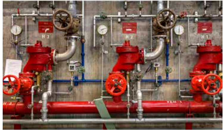
Válvulas de control del sistema contra incendios, Planicie Banderita.
