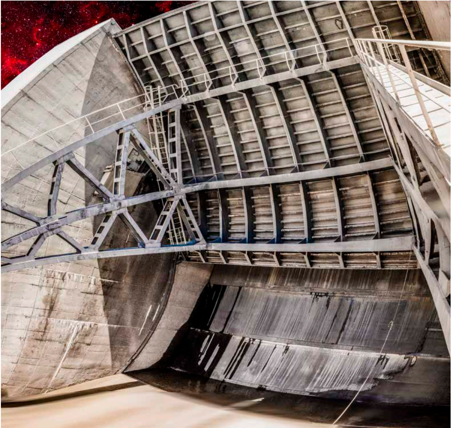
Compuerta del vertedero de El Chocón. Neuquén y Río Negro.
