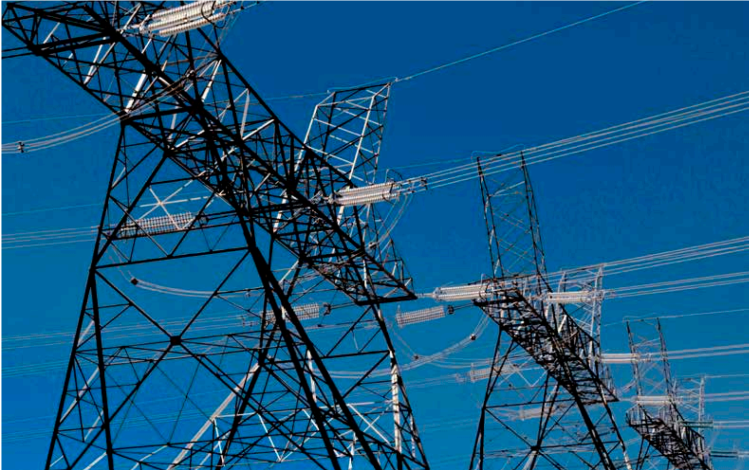
Torres de alta tensión del Sistema Interconectado Nacional. El Chocón, Neuquén y Río Negro.
