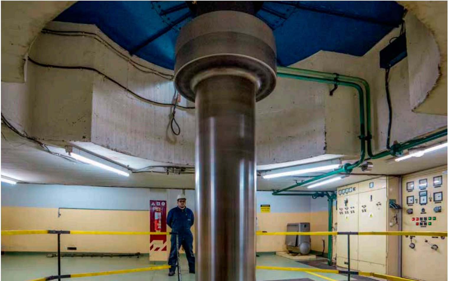
Eje de vinculación entre turbina y generador, central Florentino Ameghino, Chubut.
