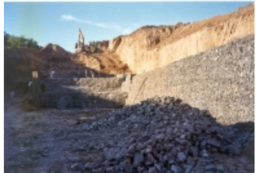
Obra de protección de erosión en la cárcava del Arroyo El Gato – Provincia de Córdoba
