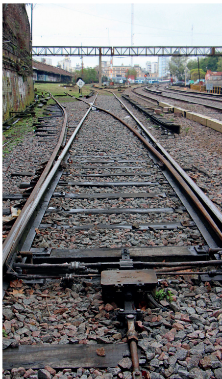
Caminos alternativos de superficie irregular para acceder al sector de cabinas y/o zonas de vías
