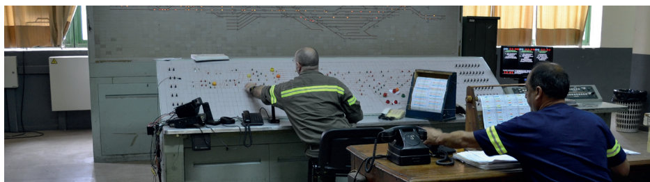
Operadores de cabinas eléctricas.
