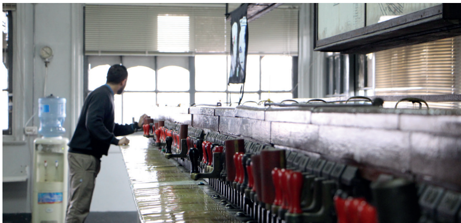
Cabina electroneumática -Accionamiento de palanca electroneumática.
