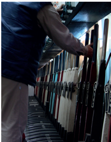
Cabina mecánica que muestra las palancas en posición NORMAL, colocadas hacia atrás
