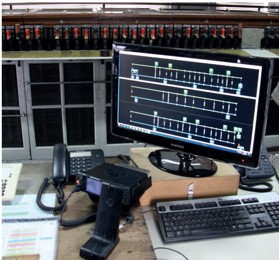
Cabina mixta o electromecánica
