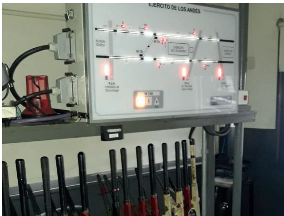
Cabina mecánica - accionamiento manual de palancas.
