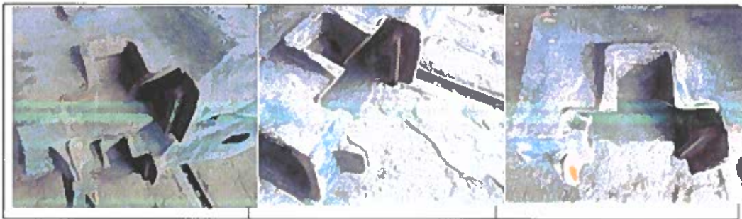
SUPERFICIE DE APOYO DE LAS CUÑAS CON UN EXCESIVO DESGASTE
