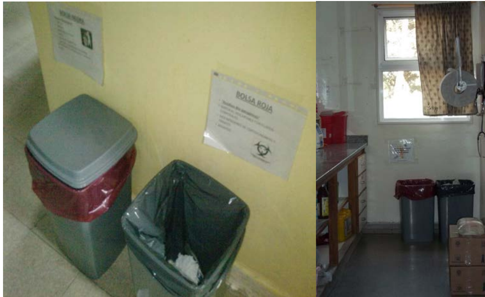
Cestos para segregación de residuos comunes y biopatogénicos
