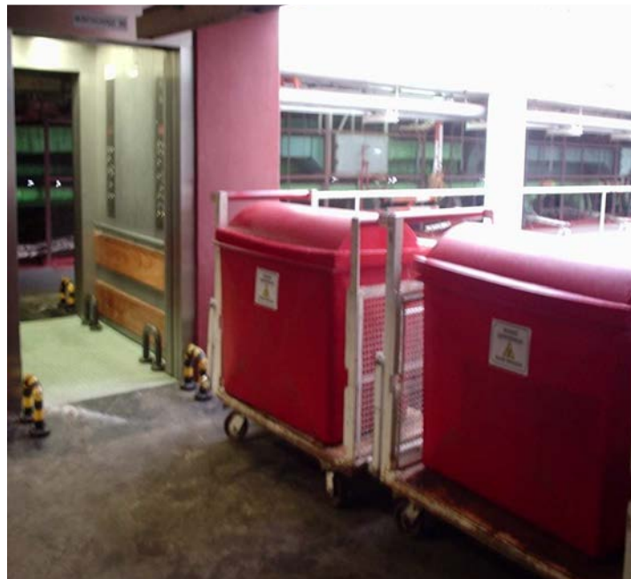
Puntos de transferencia en entrepiso técnico
