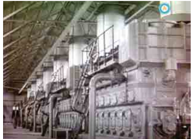
Planta compresora del Gasoducto Presidente Perón, en Comodoro Rivadavia.
