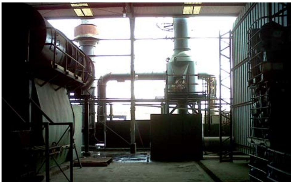
Instalación de manejo de residuos peligrosos (sistema de horno de incineración pirolítico). Operación de Eliminación Sección A D10 "Incineración en la Tierra" Anexo III Convenio de Basilea
