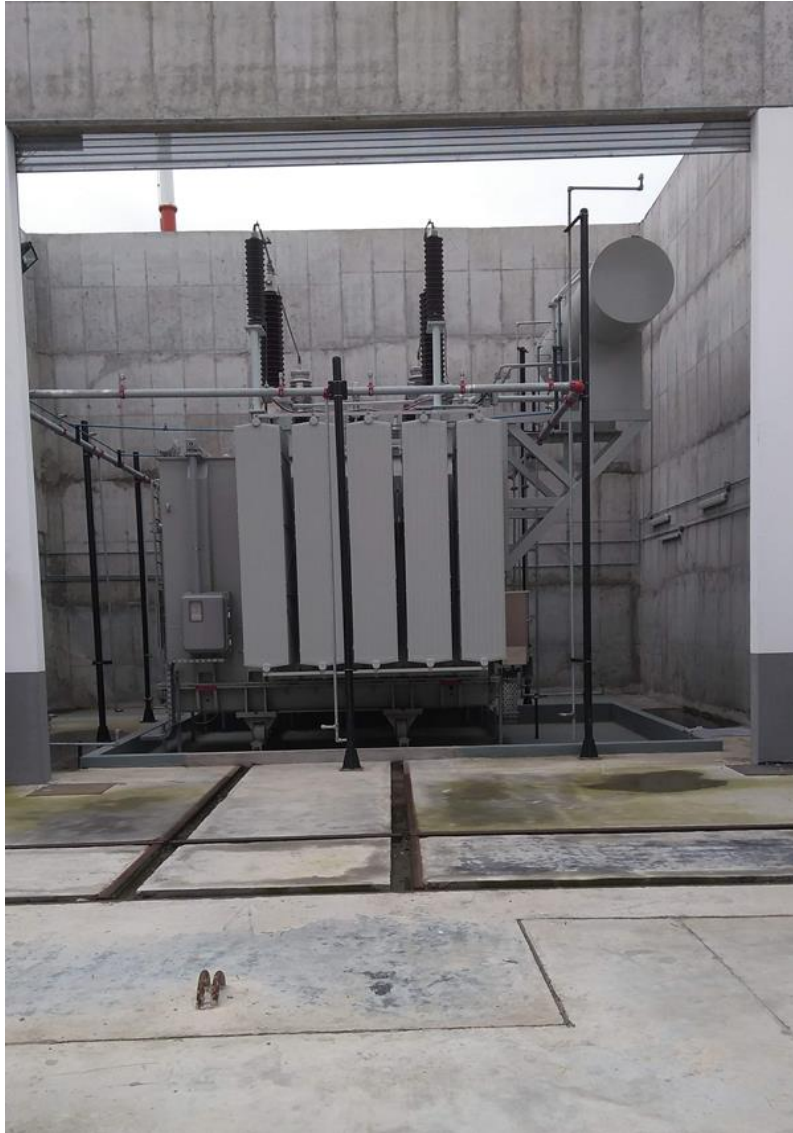
Foto 4. Transformador de distribución. Obsérvese por debajo de éste la batea de contención de derrames (imagen de referencia, SET Quilmes).
