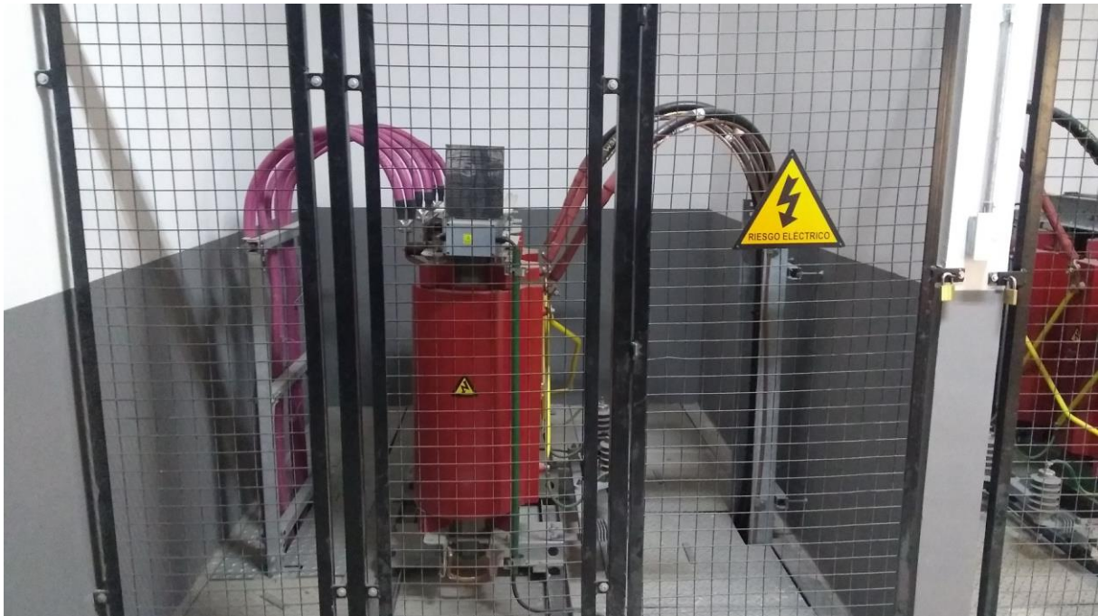
Foto 2. Transformador seco de servicios auxiliares (imagen de referencia, SET Quilmes).
