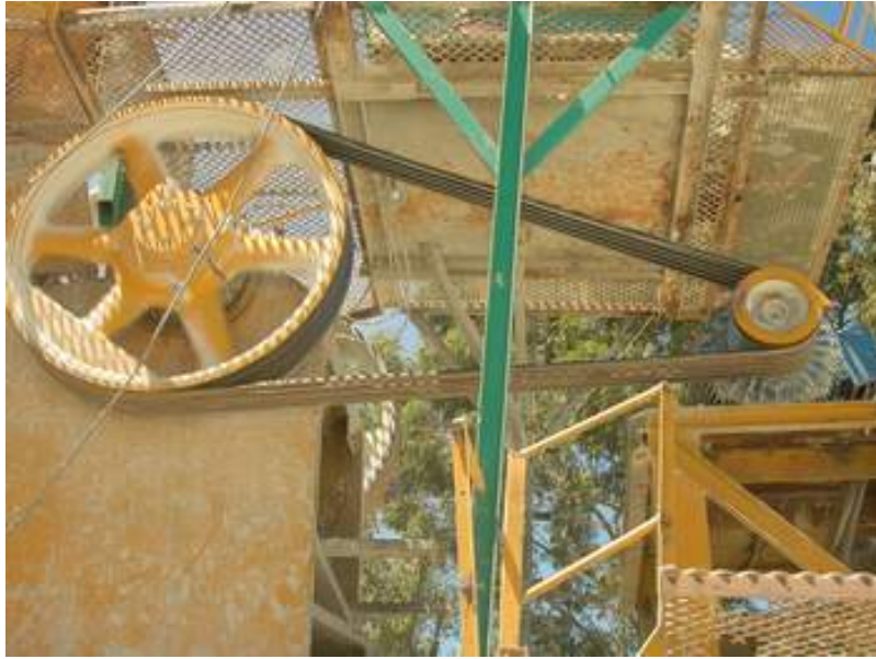
Volantes y poleas sin protección
