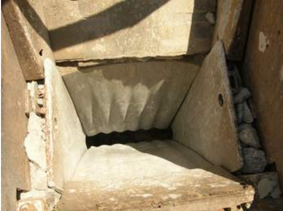
Tolva y boca de entrada de la trituradora
