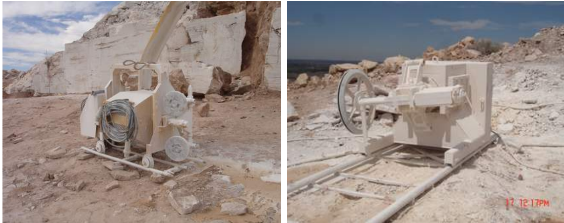
Máquina con la que se produce el corte por medio de hilo diamantado
