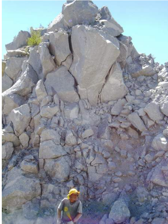
Riesgos de desprendimientos de rocas
