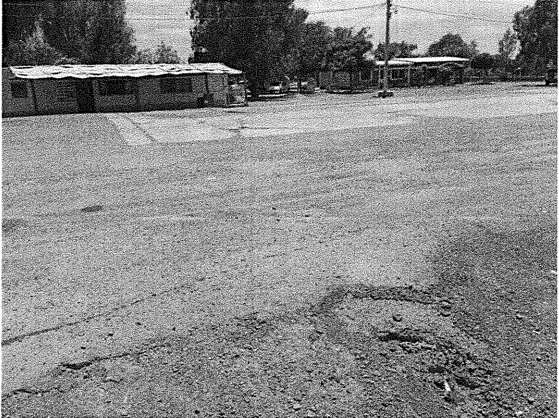
Interferencias en la zona de camino
