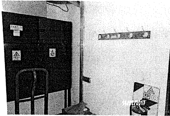
Sala de Electricidad
