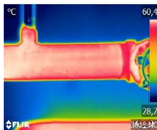
Tramo de cañería perteneciente al sistema de calefacción del Edificio Esparza en el CAB.
