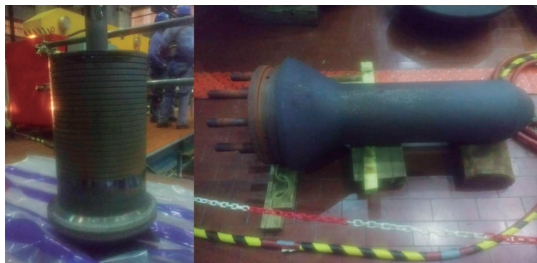
Desarme de la válvula de emergencia (izq.) y válvulas combinadas (der.) del turbogruppo
