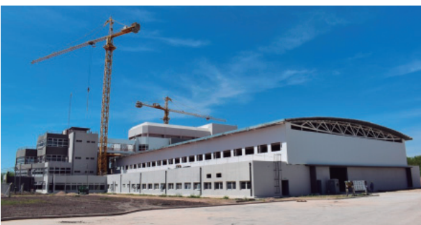
Reactor Multipropósito RA-10 en construcción en el Centro Atómico Ezeiza (Crédito CNEA, diciembre 2022)
