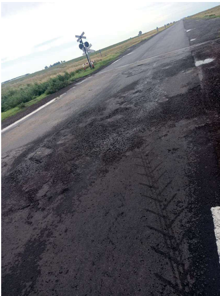
Figura 12. Calzada posterior al paso a nivel, con daños provocados por el incendio que se produjo luego del accidente del 21 de agosto de 2022. Fuente: JST, 2023
