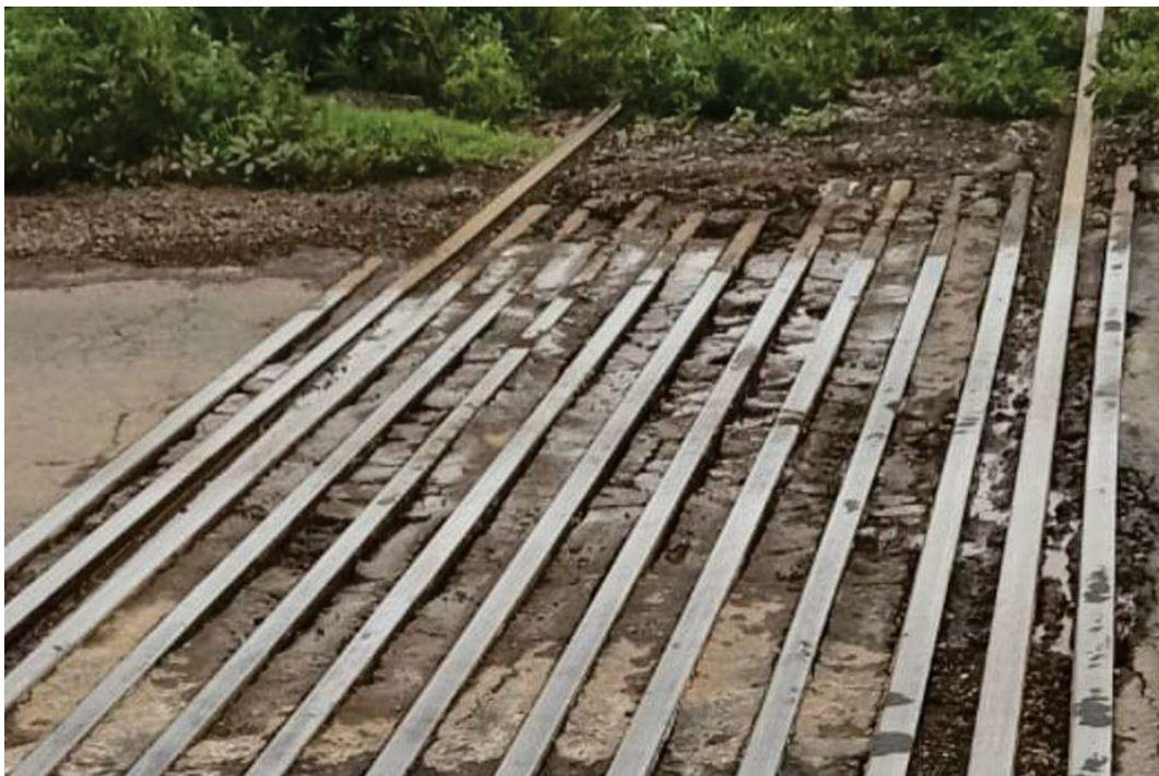
Figura 13. Lodo sobre la cama de rieles del paso a nivel de la RN 7. Fuente: JST, 2023
