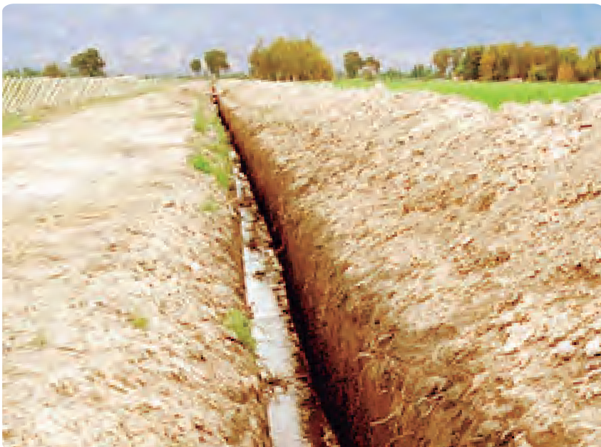
FOTO 10 Dren parcelario a cielo abierto.
