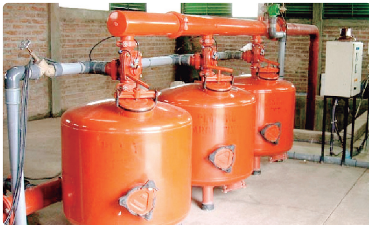
FOTO 06 Conjunto de filtros de gravas.
