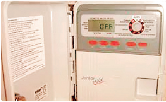
FOTO 11 Controlador de riego.
