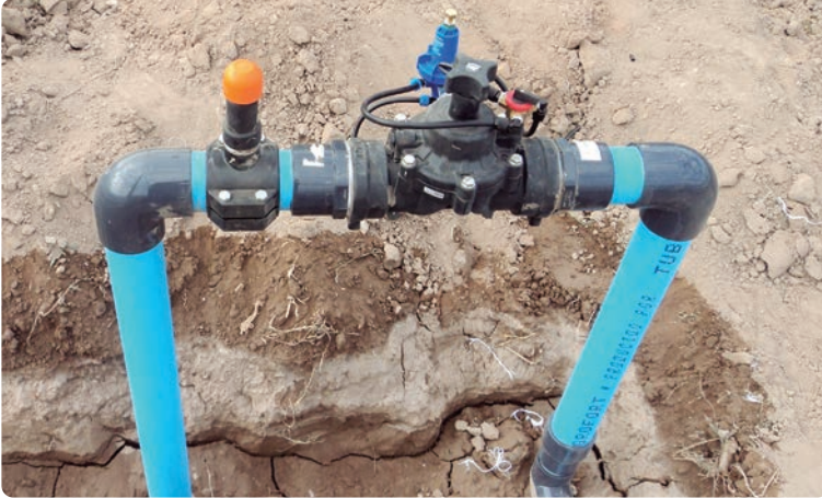
FOTO 13 Cabezales de campo con válvulas hidráulicas instaladas.
