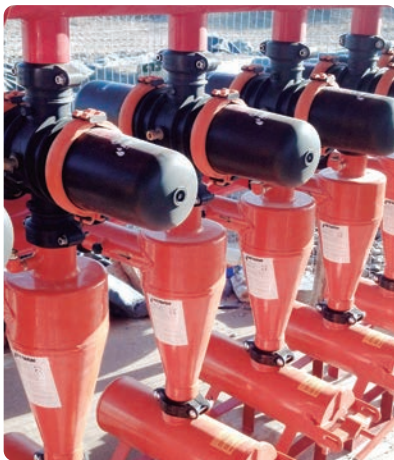
FOTO 05 Conjunto de hidrociclones.
