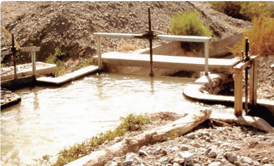
FOTO 05 Compuertas frontal y lateral.
