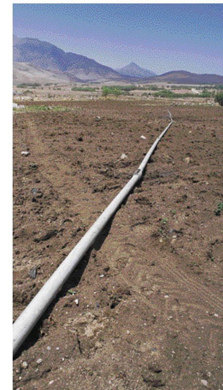
▲ Conducción por tuberías a presión gravitacional, Tafí del Valle. Tucumán.
