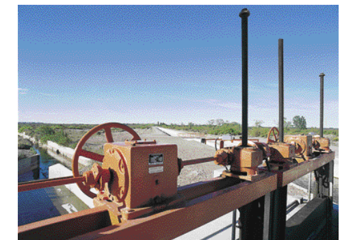
▲ Primera foto Mecanismo de compuertas en el 5º tramo del canal San Martín en el río Mendoza.
