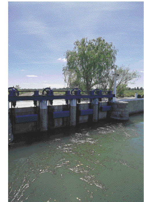
▲ Sistema de compuertas a reacondicionar en las obras del proyecto Reducción Los Andes. Mendoza.
