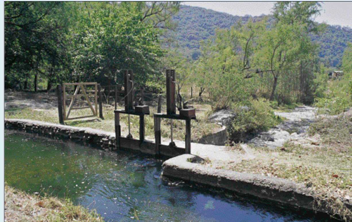
▲ Compuerta de descarga de fondo. Proyecto Desarrollo del Área Irrigada de Lules. Tucumán.
