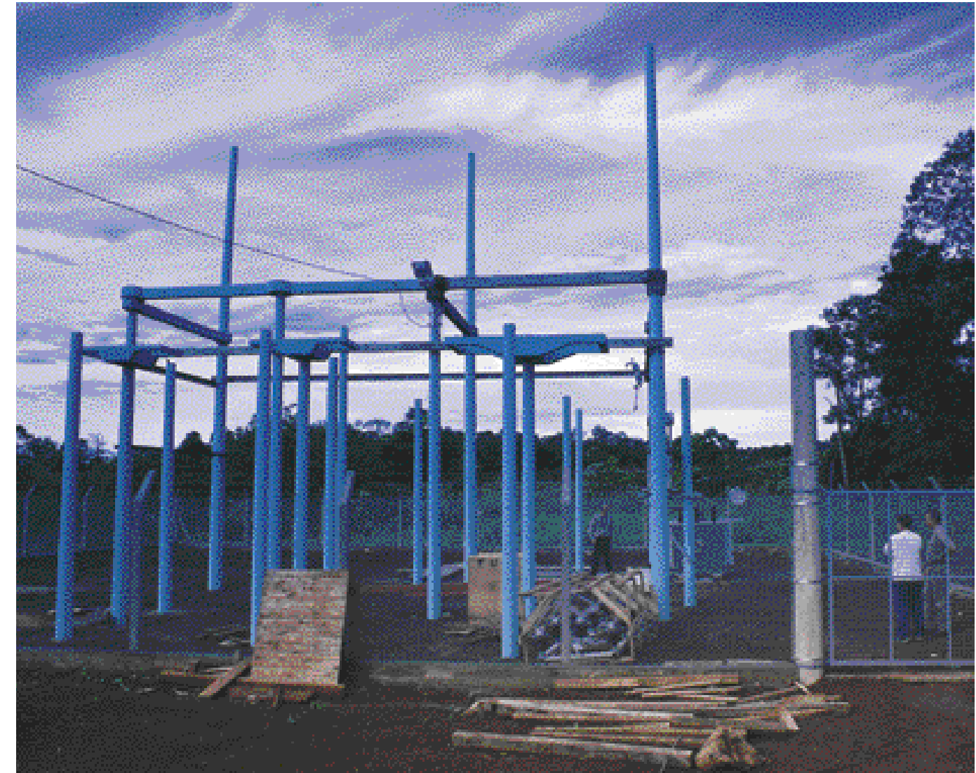
▲ Estación transformadora en Andresito. Misiones.
