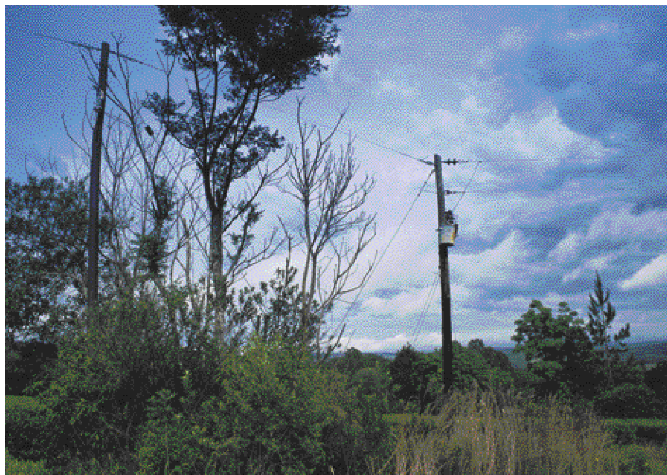
▲ Tendido eléctrico del Proyecto Arroyo Yaza, Oberá, Misiones.
