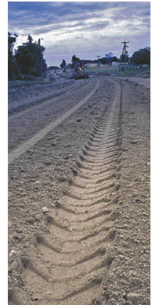
▲ Distribución de suelo calcáreo para base de asiento en Victoria. Entre Ríos.
