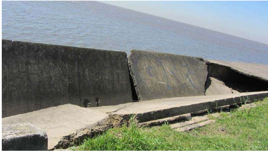
Figura 2.28. Defensa deteriorada - Zona Pejerrey Club.
