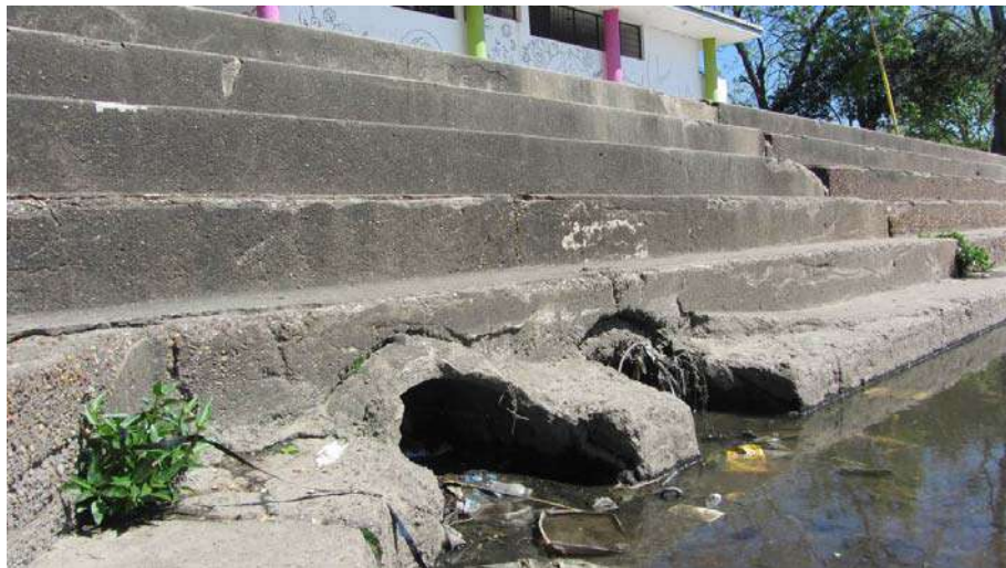
Figura 2.19. Descargas pluviales - Zona Pérgola.
