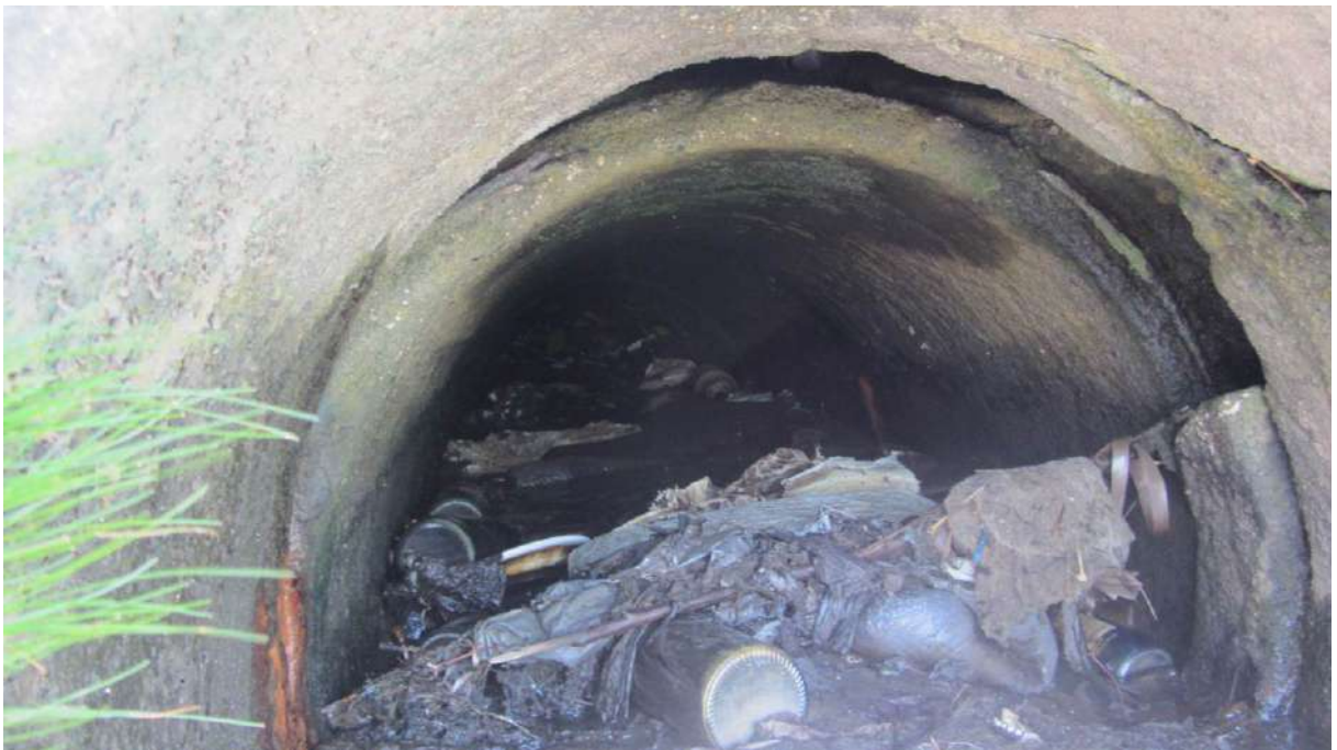
Figura 2.22. Residuos sólidos obstruyendo descarga pluvial - Zona Pejerrey Club.
