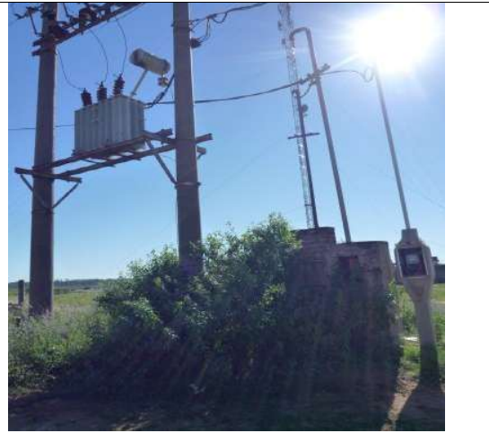
Estación transformadora de media tensión en el camino de acceso al predio. Abastece al mismo y a la zona.
