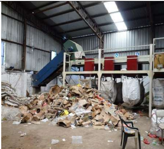
Cinta elevadora y de picoteo de materiales en el interior de la Planta de Recuperación del predio (Obs.: no se encontró en operación al momento de la visita).
