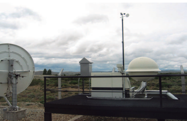
Estación de monitoreo de radionucleidos RN03 en Bariloche, provincia de Río Negro
