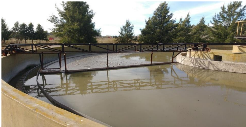
Imagen 4: Barredor superficial del Tanque Imhoff
