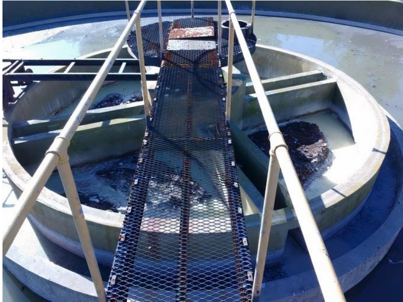
Imagen 3: Cono central del Tanque Imhoff
