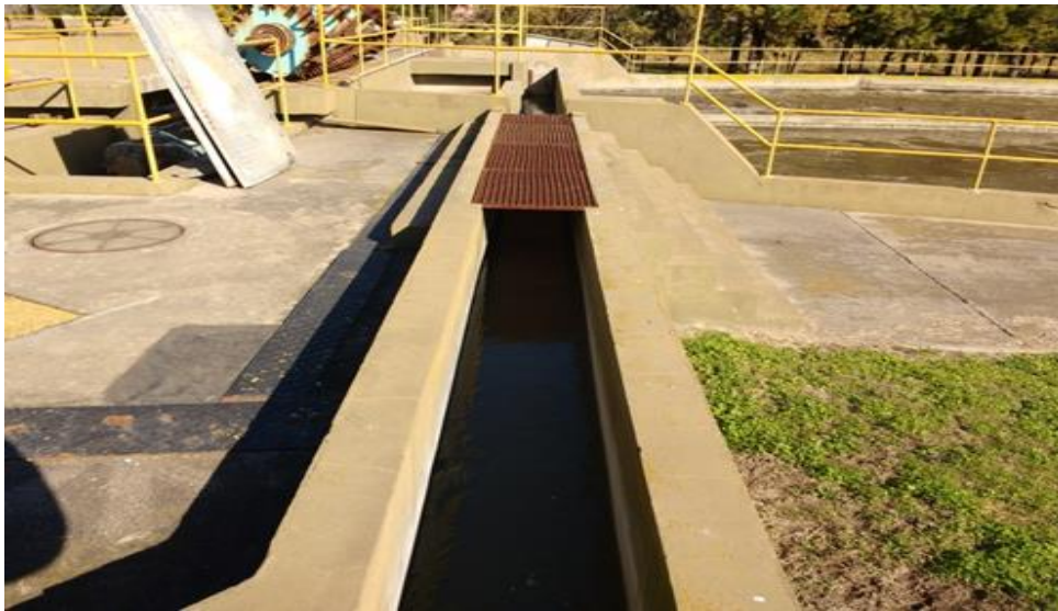
Imagen 7: Canal de acceso al reactor
