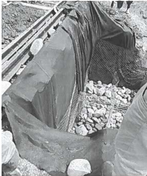
Detalle 12: Imagen correspondiente al armado en obra de estructura de gaviones para contención de terraplén de aproximación al puente.
