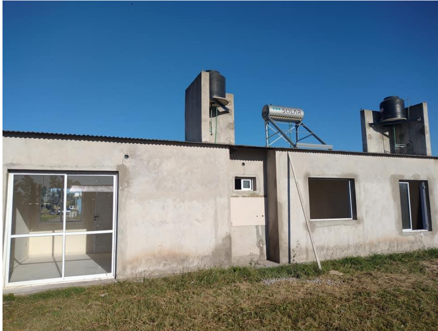
Termotanque solar colocado en viviendas construidas sobre terrenos del Banco de Tierras
