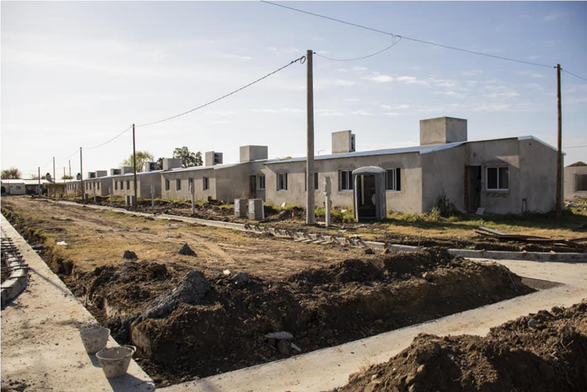
Construcción de 40 viviendas correspondientes al programa bonaerense II "Solidaridad" y obra de infraestructura de cordón cuneta.
